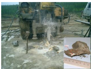
Разрушение зоны скважины с криогелем
